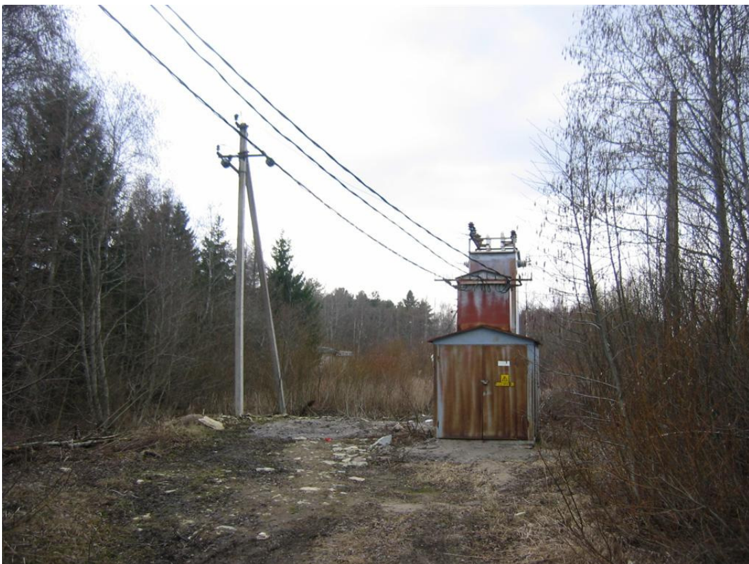
Vaade planeeringuala keskossa jäävale alajaamale ning 10kV elektriliinile
