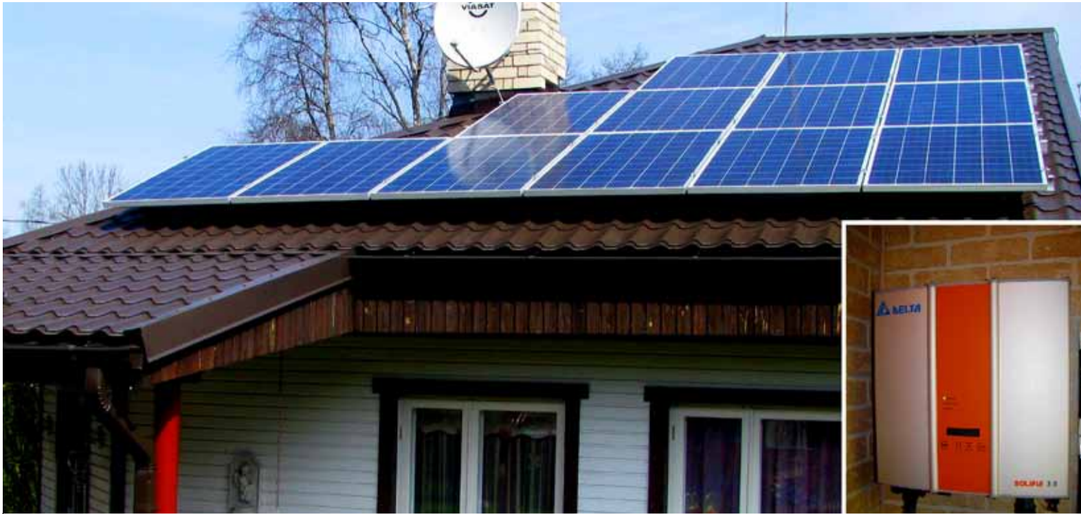
◇ Suvekodu katusele paigaldatud päikeseenergia põhinev elektrienergia mikrotootmisjaam. Foto: Harry Pajundi
