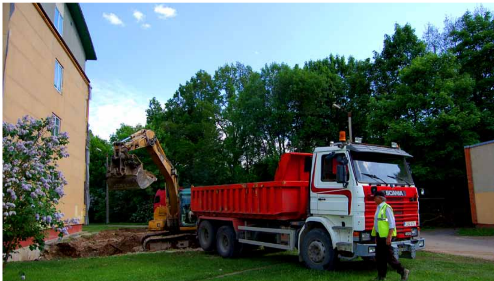
Haridus- ja Teadusministeeriumi sihtotstarbelise rahaeraldise, 40 000 eurot kooli tarbeks kulus kooli ruumiprobleemide lahendamiseks, sh algklassidele lisaruumide loomiseks. Ministeerium kiitis rahakasutuse heaks. Laienduste ehitus käib. Foto: Sirje Piirsoo
