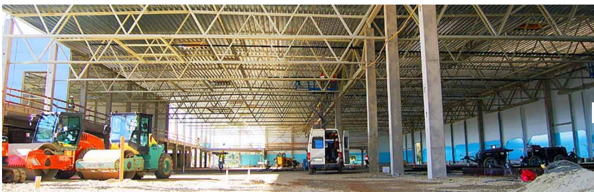
Uue tehase ehitus Sauele on jõudnud järku, kus „karp“ on valmis. Kaugel ees paistvast uksest siseneb tehhi tooraine, valmistoodang väljub hoone teisest otsast. Foto: Sirje Piirsoo
