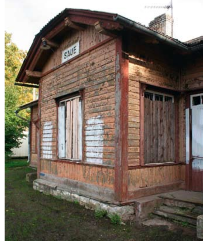
Välisvoodrilt koorub värv, veelaud on mädanenud, välisreppid on lagununud, akendel puuduvad klaasid ja osad raamid.
